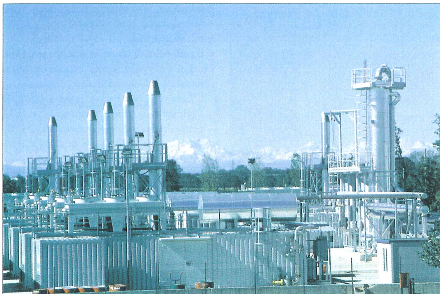
Fig. 1 – Centrale Bioelettrica della discarica di Inzago (MI) – MESBG-EC
